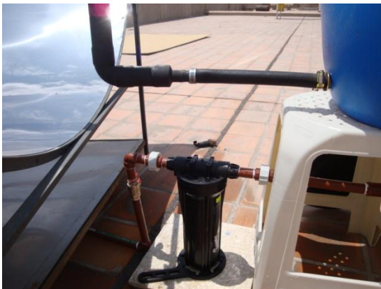
Fig 3. Filtro previo al ingreso de agua
