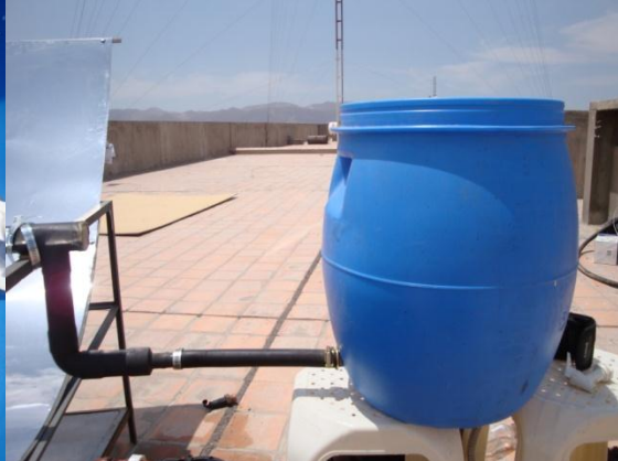
Fig 2. Tanque de alimentación de agua al destilador
