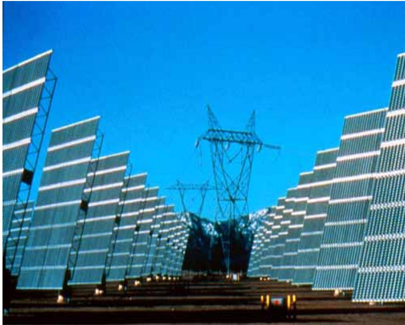
1 MWp, Primera central – California
