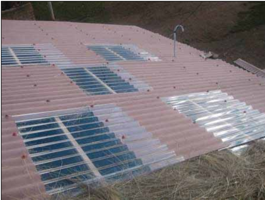
Calaminas transparentes. Alta transmitancia solar hacia el interior
